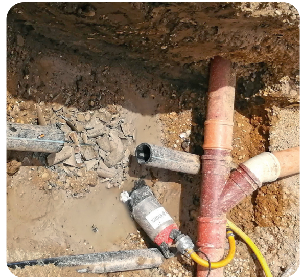
Ablagerungen von Innenputz im Abwasserkanal
