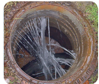
Grundwassereintritt im undichten Kanalschacht.
