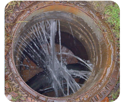
Grundwassereintritt im undichten Kanalschacht.
